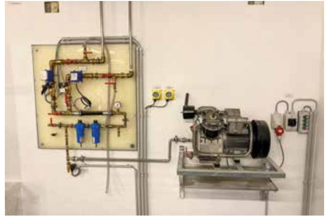
Foto Neue Kompressoranlage mit Steuertableau für die Druckstoßkesselanlage
