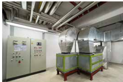
Fotos Neue Lüftungsanlagen am Standort Siegelknippen
