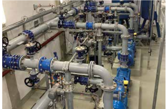
Foto Neue Trinkwasserförderpumpen inklusive Saug- und Druckleitungen nach Fertigstellung
