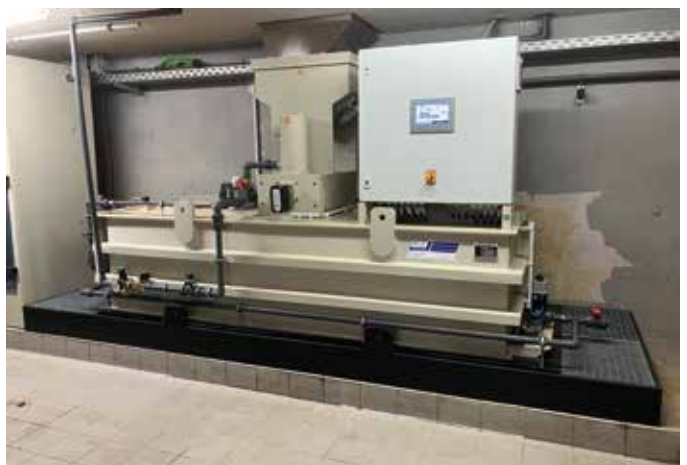
Foto Neue Polymeransetzanlage
