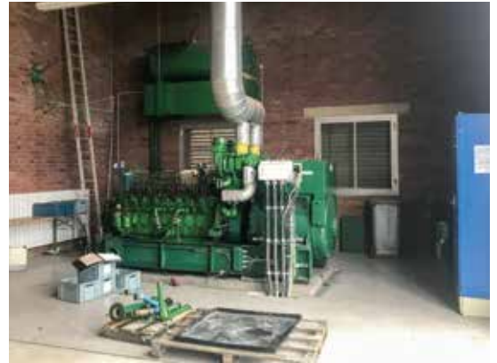
Fotos Mitte und unten Neue Netzersatzanlage
