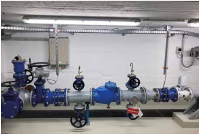
Foto Übergabeleitung nach Eitorf
