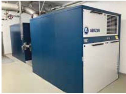
Fotos Neue Anlage Spülluftgebläse
